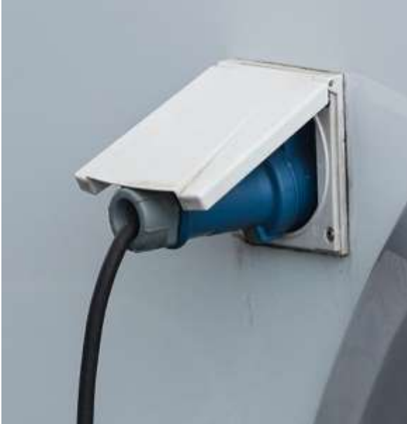
Netzanschluss Dose Beifahrerseite unter dem Fenster.
